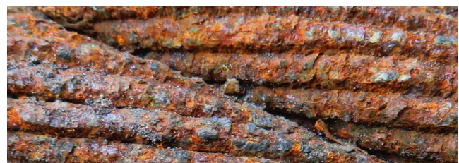
Vergrößerung von äußerer Korrosion
