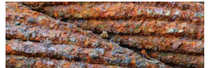
Fuerte corrosión externa
